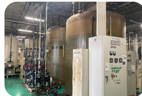
純水製造設備
