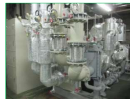
〈クリーンルーム冷房用冷凍機〉
