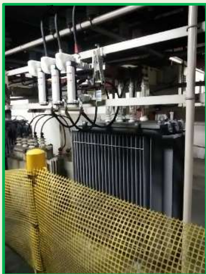
3棟電気室トラン
