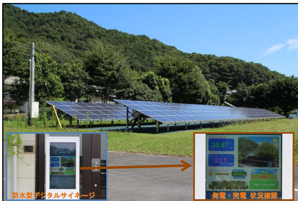
発電所の全景
